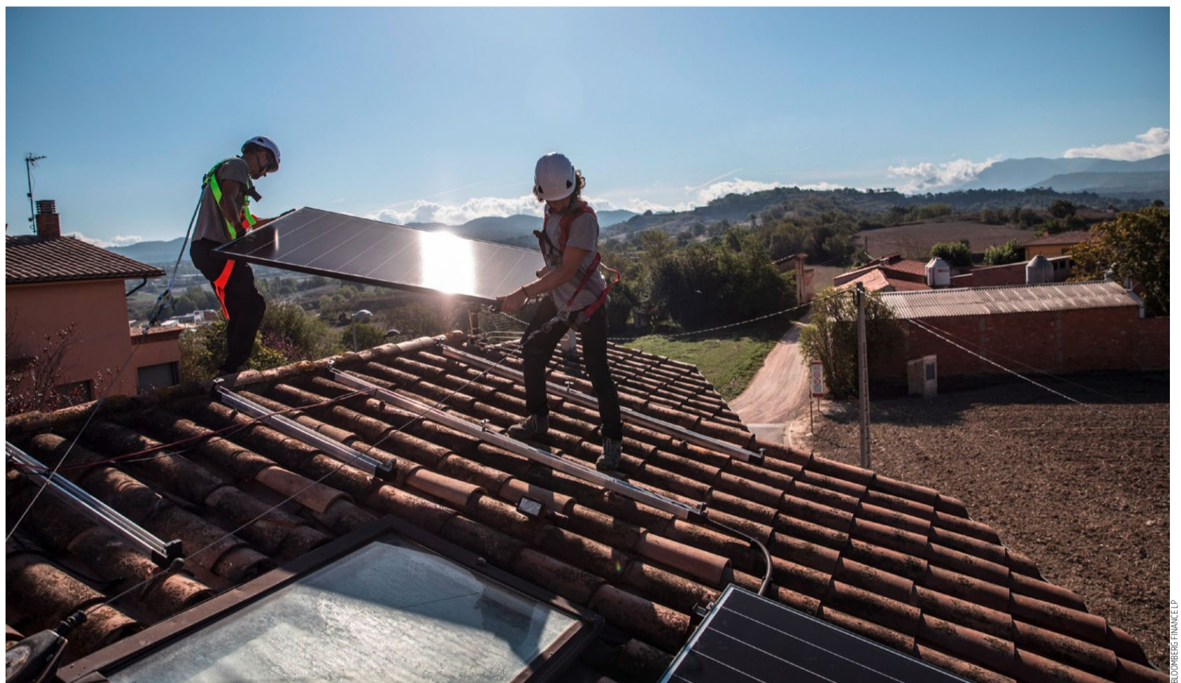
Solardächer: Die Ausstattung der Dächer mit Solarpanels macht die Stromversorgung nachhaltiger, günstiger und unabhängiger.
